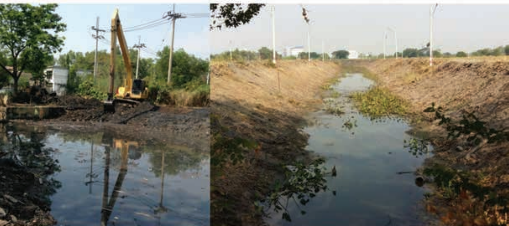
ดำเนินการขุดลอกวัชพืชที่กีดขวางทางน้ำ องค์การบริหารส่วนตำบลบ้านฉาง อำเภอเมืองปทุมธานี จังหวัดปทุมธานี
